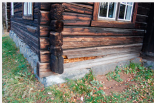
Halvtotal råteskader. Takdrypp som slår opp på de nederste stakkene, forårsaker mange skader.
